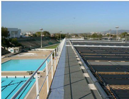
Photo 2 : Moquette solaire de la piscine de Villeurbanne
