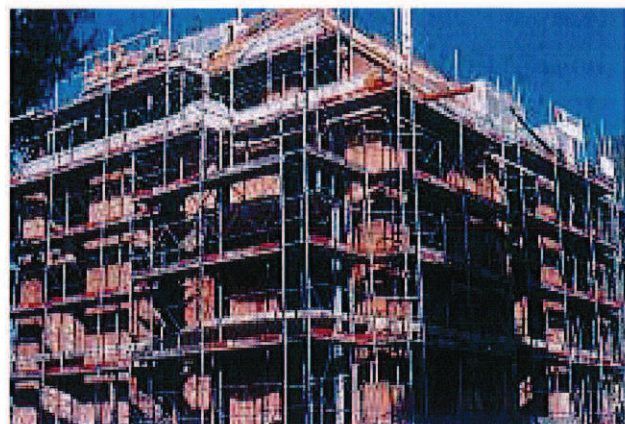
12/1 De tels bâtiments en maçonnerie – et même de moins hauts – sont extrêmement sensibles aux tremblements de terre s'ils ne sont pas renforcés par des parois porteuses en béton armé (Suisse, 2001).
