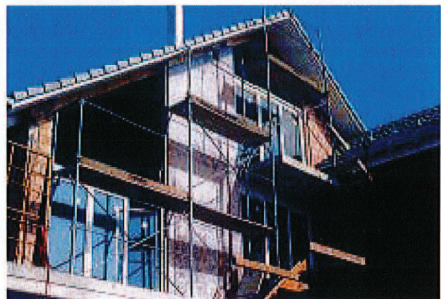
12/2 Cette nouvelle villa de trois étages, comprenant des parois porteuses en maçonnerie non-armée, est renforcée longitudinalement par une paroi porteuse en béton armé dans chaque façade et transversalement par un mur de refend disposé à l'intérieur du bâtiment (Suisse, 2001).
