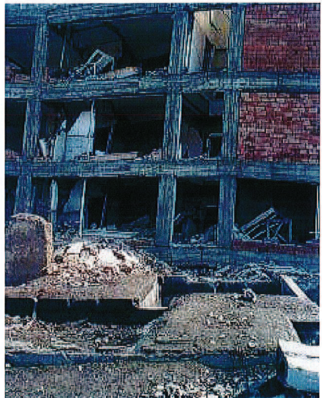
11/1 Ici, les colonnes étaient manifestement les plus résistantes. Une grande partie de la maçonnerie est tombée, mais le cadre a tenu (Erzincan, Turquie, 1992).
