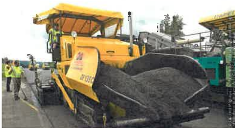
Chantier d'enrobé autoroutier en Lozère. Le taux de réintroduction des agrégats d'enrobés dans les enrobés bitumineux est passé de 5,8 % en 2009 à 12,9 % en 2014.
