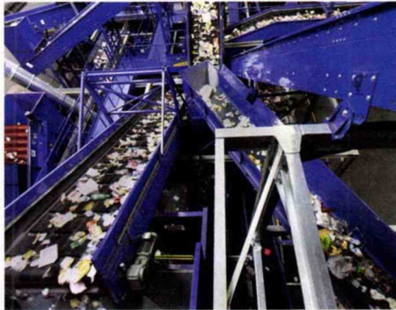
L'usine Paprec du Rheu est le plus grand centre de tri «à l'extension» en fonctionnement aujourd'hui. Il n'a pas encore atteint sa capacité nominale.
