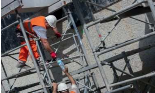
Sur le chantier géré par Colas Génie civil, les facteurs climatiques ont été appréciés au jour le jour, avec une organisation particulière les journées les plus chaudes : horaires décalés, multiplication des pauses... © Fabrice Dimier pour l'INRS
