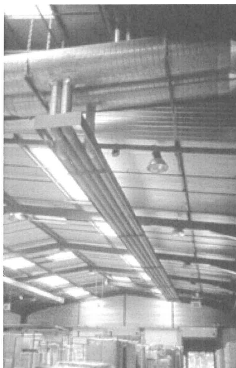
Photo 5.3. Chauffage des locaux réalisé à partir de canalisations d'air chaud agissant par rayonnement.
