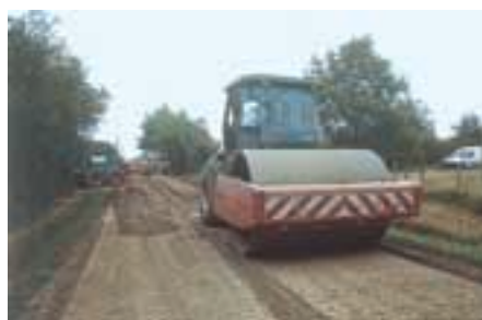
Profil définitif de la chaussée en double pente après nivelage et compactage.
