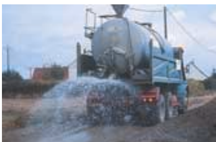
La structure est arrosée pour corriger la teneur en eau avant le malaxage final.
