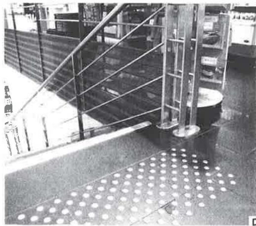
D Elles remplacent les clous fixés au sol, car tout perçement est proscrié, en raison de présence éventuelle d'amiante dans les colles des revêtements de sol.
