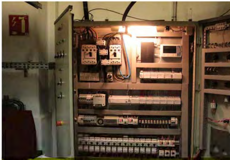
La régulation fine de la chaufferie et de l'aération est un facteur important d'économies d'énergie.
