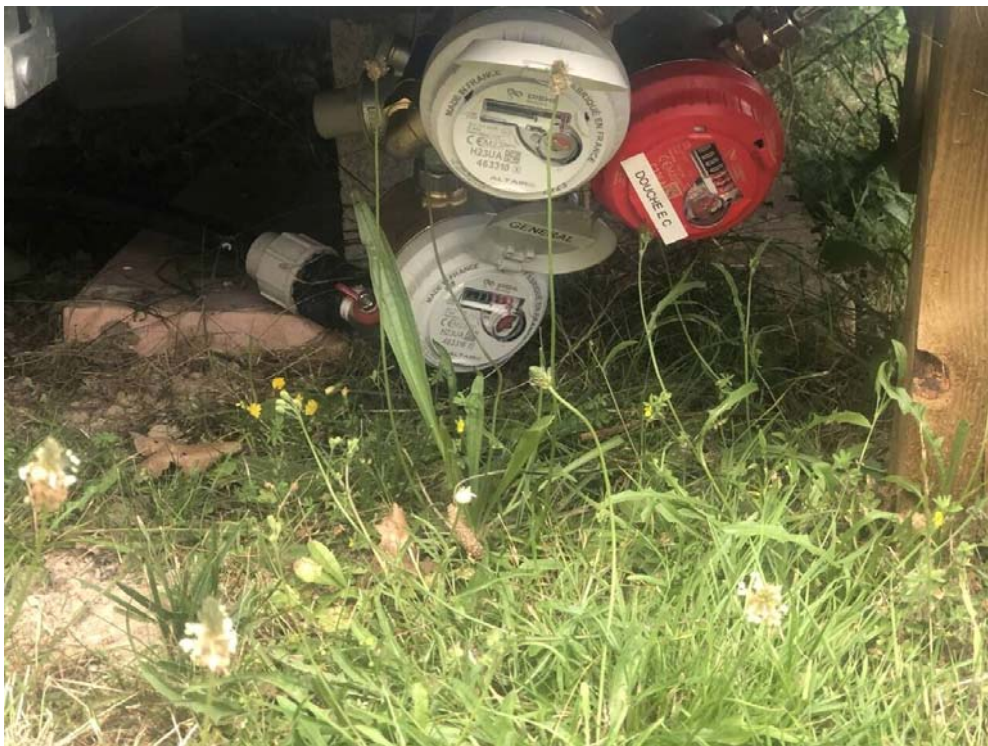
Des compteurs pour mesurer les différentes consommations d'eau équipent certaines parcelles du camping de la Guyonnière à Saint-Julien-des-Landes – OUEST-FRANCE
