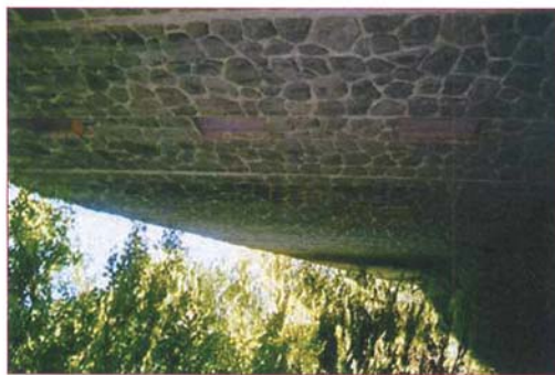
FIGURE 10 - Ouvrage renforcé EBAL - LCPC de l'Hospice de France - Vue du parement. (Ouvrage construit en 1985)
